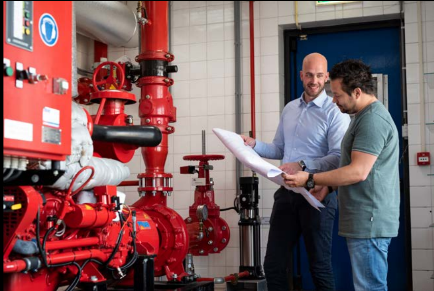
Rens staat bij een proefopstelling van een rode sprinklerinstallatie.
